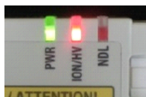
Detección de anomalía por alta tensión
