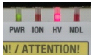
Detección de anomalía por alta tensión
